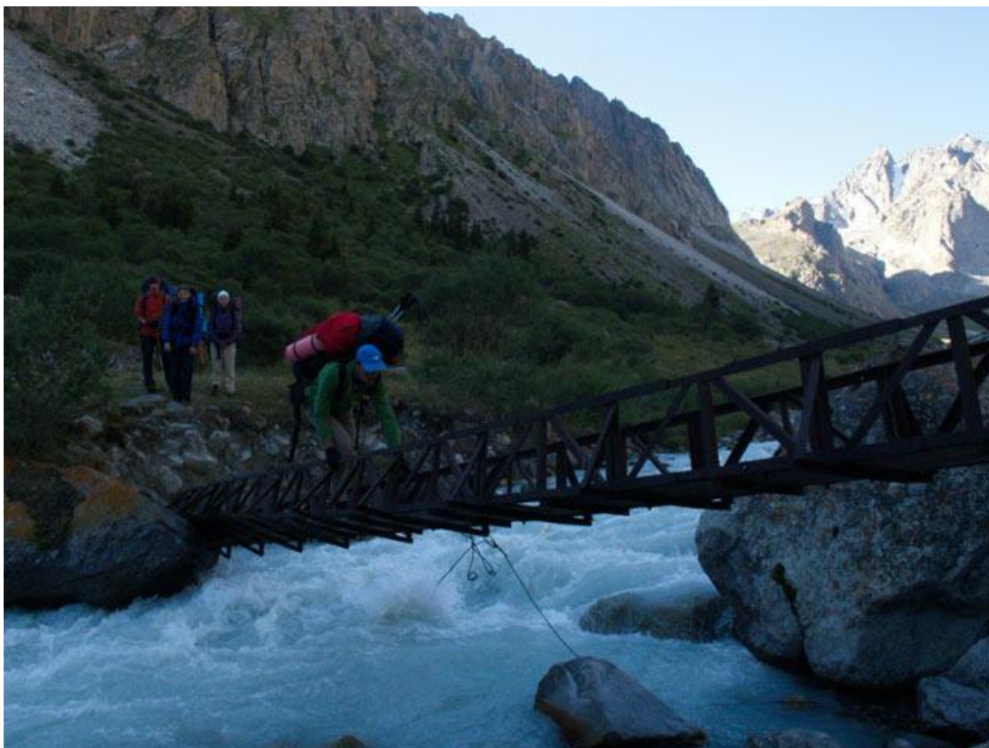
Рисунок Б.80 – Полуразрушенный мост через р. Ала-Арча
