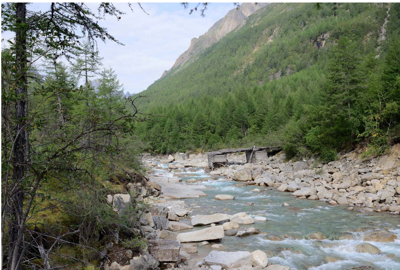
Фото 114. Разрушенный мост через р. Ср. Саукан
